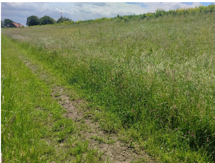
Figuur 11: Op het dijktaalud van de Spaarndammerdijk is de grasdominantie duidelijk zichtbaar. Kansrijke stukken zitten veelal in de zone direct langs de weg en op het ondertalud.
