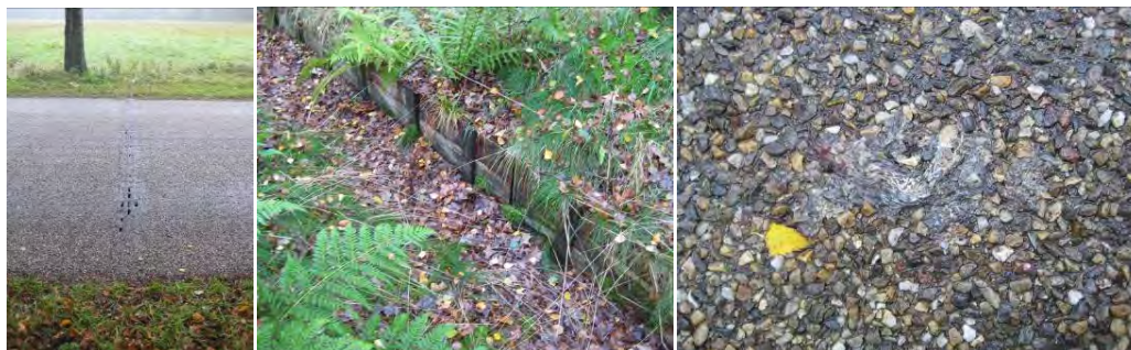
Figuur 9: Faunavoorzieningen aan de Oudemolenseweg functioneren niet meer en vooral het geleidingsscherm dient te worden vervangen. Rechts een overreden gewone pad. (Foto's: R. Struijk)
